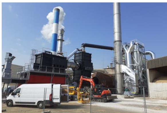
Foyer biomasse 11 MWh en séchage de luzerne.
